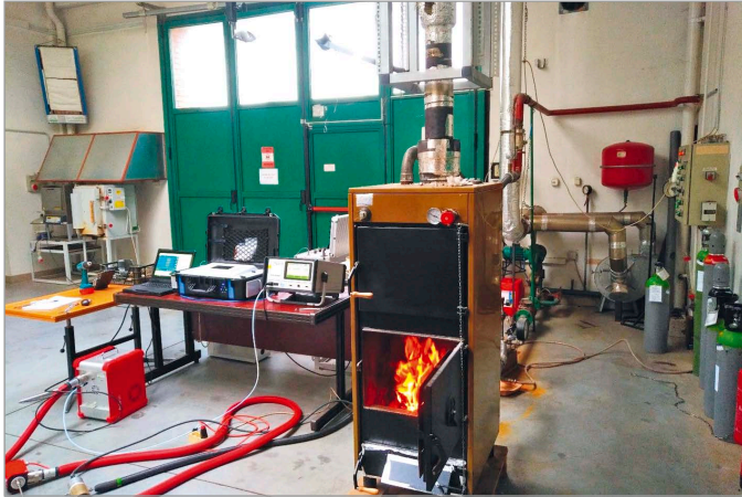
4. ábra Tüzelőberendezés tüzeléstechnikai és környezetvédelmi vizsgálata
